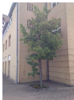
Plantehul for lille og forkert placering. Kræver evig beskæring i forhold til bygning
