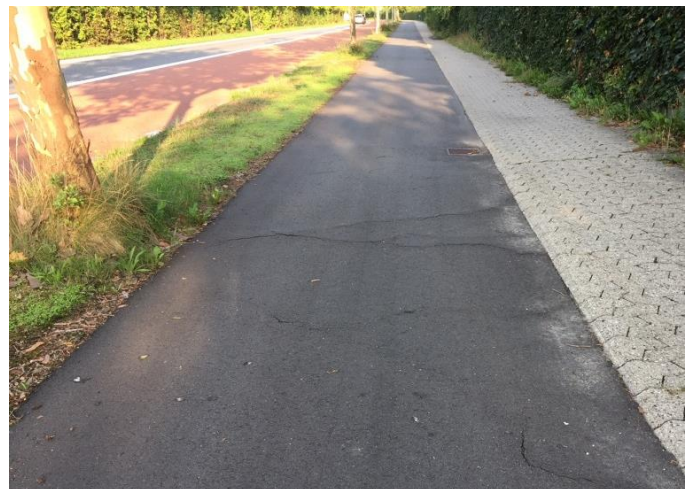
Platantræ på Kollekollevej som gentagne gange ødelægger asfaltbelægningen med sine rødder. Her kan løsningen være, at etablere et rodvenligt bærelag under cykelstien, så rødderne får mulighed for at vokse dybere ned.
